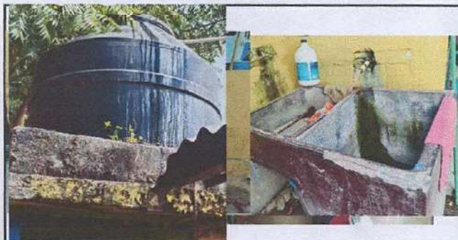
Foto 5: El depósito de agua o tinaco se encuentra en mal estado aparte de que es muy pequeño, y pila que existe es la que sirve de lavamanos para los niños y está en mal estado, es necesario sustituirlo por un lavamanos solido.
