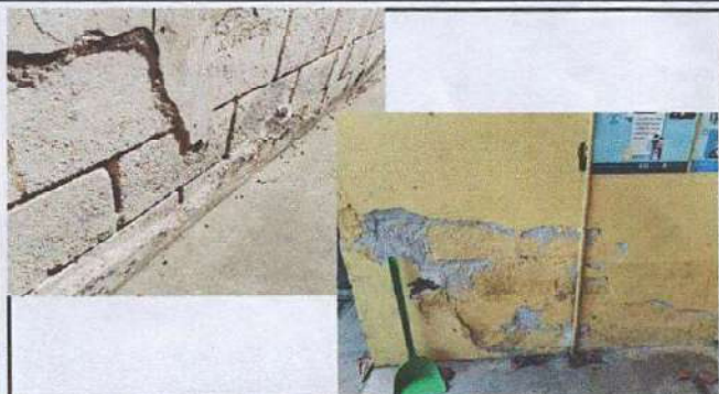
Foto 7: Existen partes, principalmente en la parte baja de las paredes que han sufrido desprendimiento en el repello y cernido, lo que requiere un resane de las paredes.
