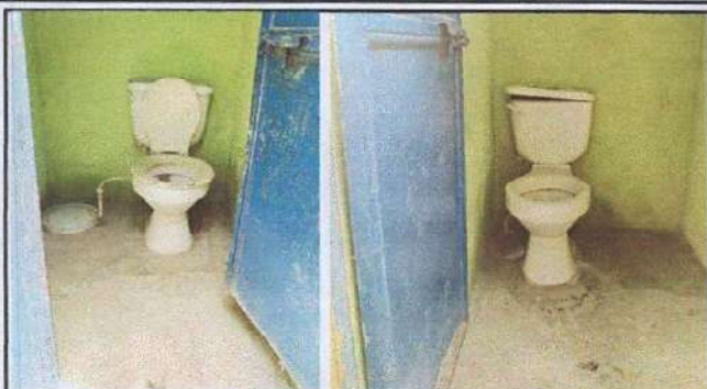
Foto 1: La escuela cuenta con servicios sanitarios en mal estado, es necesario cambiar las dos tazas que se encuentran fuera de funcionamiento
