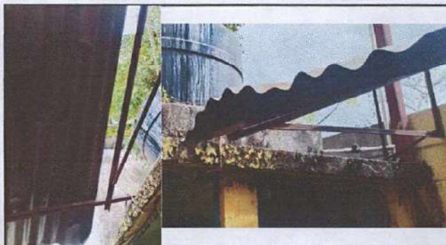
FOTO 4: La estructura y lámina entre los sanitarios, la cocina y el aula se ha desprendido y la lámina se ha deteriorado, por lo que es necesario reemplazar el techado con estructura mas solida y lamina troquelada.
