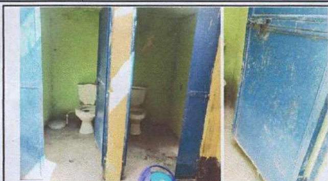
Foto 2: Es necesario reemplazar las dos puertas de metal de los sanitarios que ya están picadas y se han desprendido.
